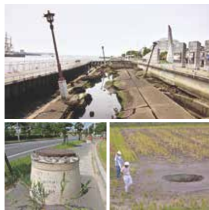
液状化による被害
