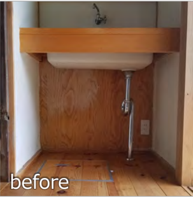
before 配管や点検口が丸見えの状態
